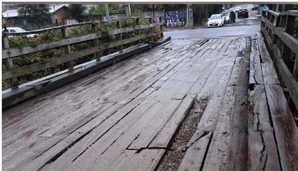
EL MAL ESTADO DEL PUENTE PFEIFFER HA SIDO UNA CONSTANTE DE LOS ÚLTIMOS AÑOS.
