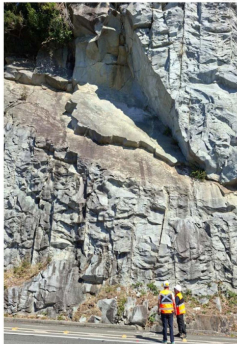
ANTE EL RIESGO DE DERRUMBE SE PROGRAMÓ UNA VISITA TÉCNICA.
