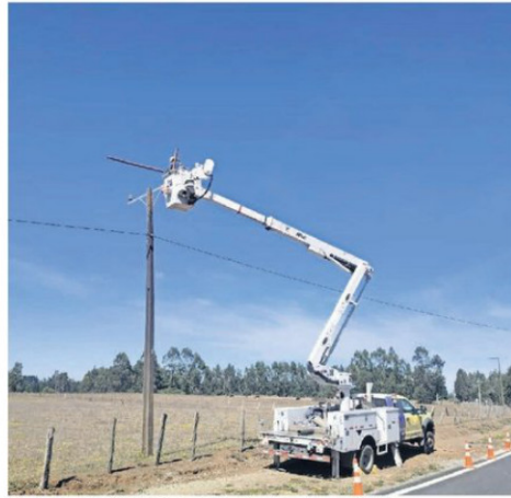
El plan incluyó fortalecimiento de estructuras eléctricas.
