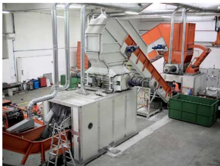
FOR REC provee sistemas altamente eficaces para optimizar la gestión de residuos eléctricos y electrónicos.
