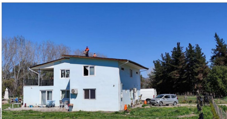
Los paneles solares ocupan todo el techo de la casa de Pirque.
