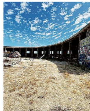
SE BUSCA EVITAR RIESGOS.
