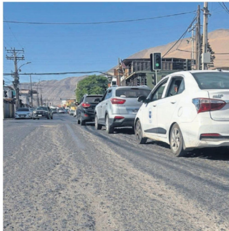
PEDRO GAMBONI CON LAS ROSAS ES DE LAS MÁS DETERIORADAS.
