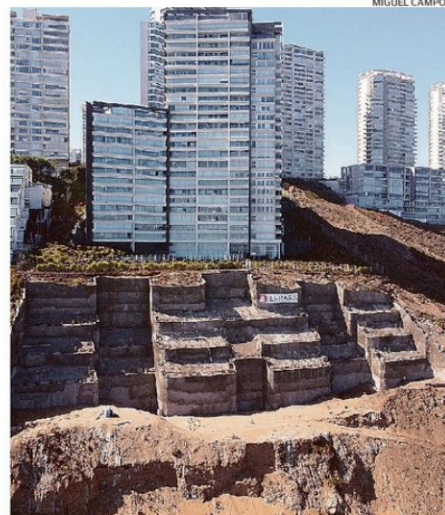
CONSTRUCCIÓN SE MANTIENE PARALIZADA DESDE EL AÑO 2020.
