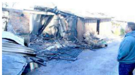
El fuego dañó casas tanto de material ligero como sólido.
