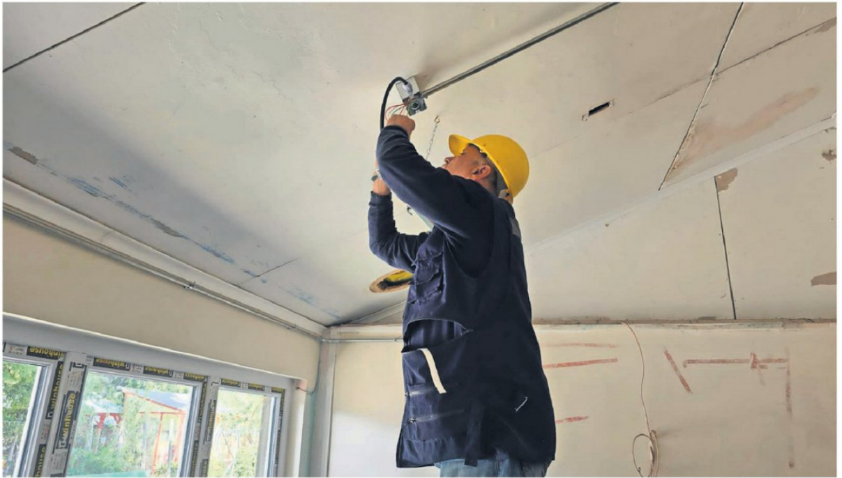
En los diagnósticos iniciales realizados en los establecimientos se detectó una alta deficiencia de los sistemas eléctricos.
