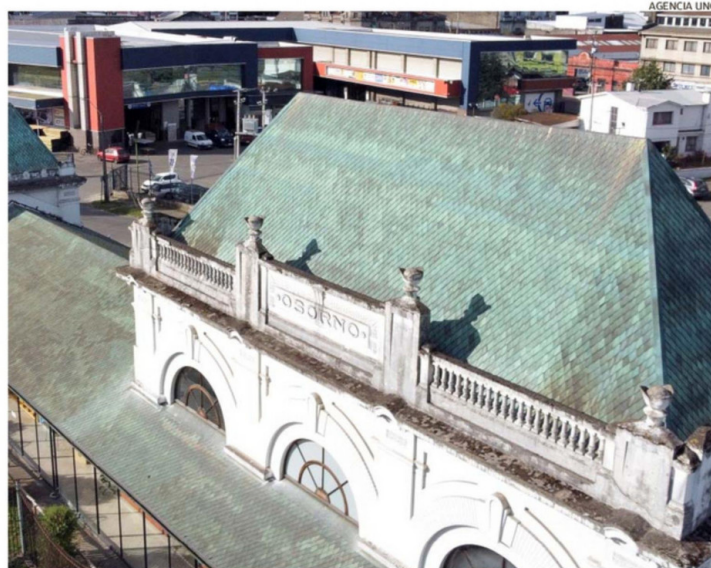
EL EDIFICIO FUE CONSTRUÍDO EN 1917 Y RECUPERADO DEL ABANDONO EN 2002. HOY LUCE DESMEJORADO.
