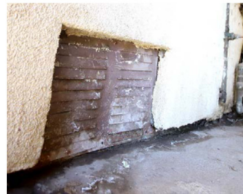
Las filtraciones por las paredes son muy evidentes en el complejo habitacional Villa Rodolfo Cortés.
