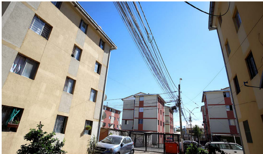
Unas 200 personas se han visto afectadas por las filtraciones en las paredes de varios departamentos de la Villa Rodolfo Cortés Ferrada en Rancagua.
