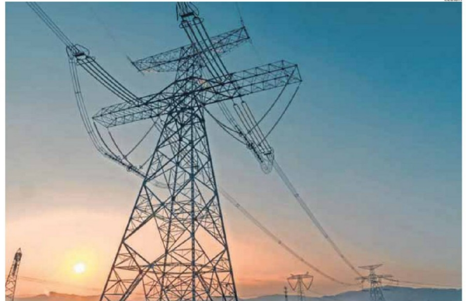
UNO DE LOS PROYECTOS ES LA LÍNEA DE TRANSMISIÓN ELÉCTRICA HVDC KIMAL-LO AGUIRRE, CON UN MONTO ESTIMADO DE US$ 1.480 MILLONES.
