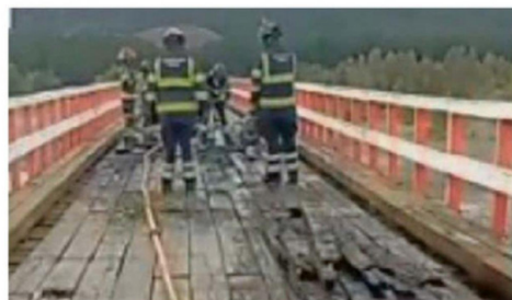
LAMENTAN INCENDIO, CONSIDERANDO MATERIAL DE LA OBRA.
