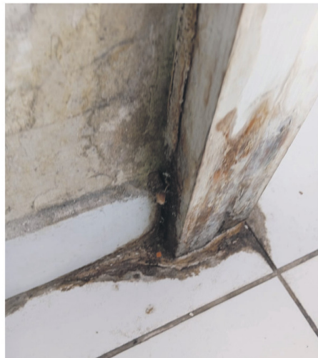
La Corte Suprema en junio ordenó corregir deficiencias sanitarias, de infraestructura y equipamiento en distintos centros de salud de La Serena.
