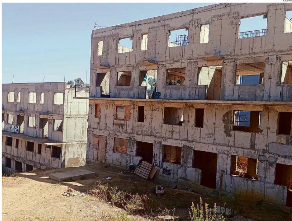
ESTADO ACTUAL DE LA CONSTRUCCIÓN DEL PROYECTO "NUEVO AMANECER" LUEGO DE QUE SUS OBRAS QUEDARAN INCONCLUSAS.
