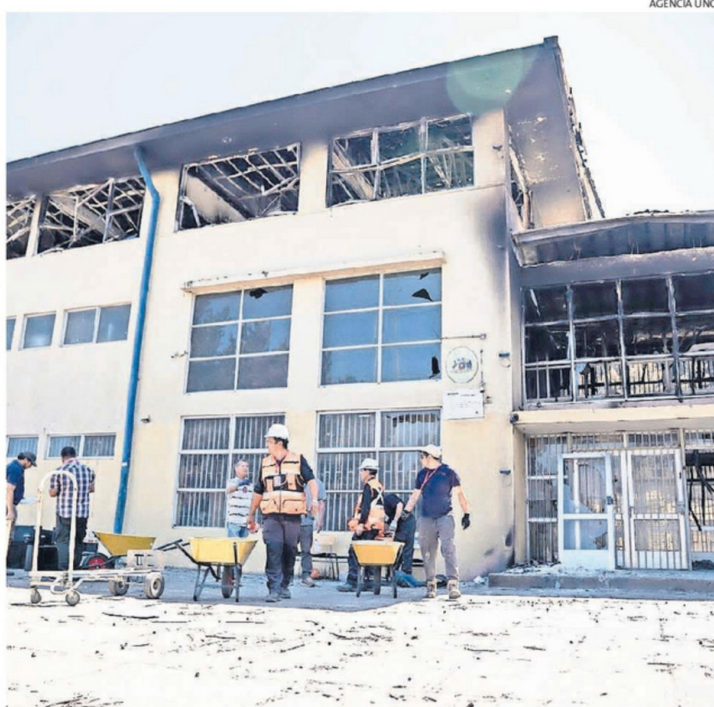
LICEO RÍOS DE CHILE FUE DAÑADO POR EL INCENDIO OCURRIDO HACE EXACTOS DOS MESES.
