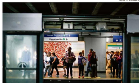
EL METRO DE SANTIAGO HA INSTALADO VENTILADORES.
