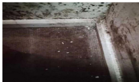
REGISTRO DEL PERITAJE TÉCNICO DE LOS ESTRAGOS DE LA HUMEDAD.
