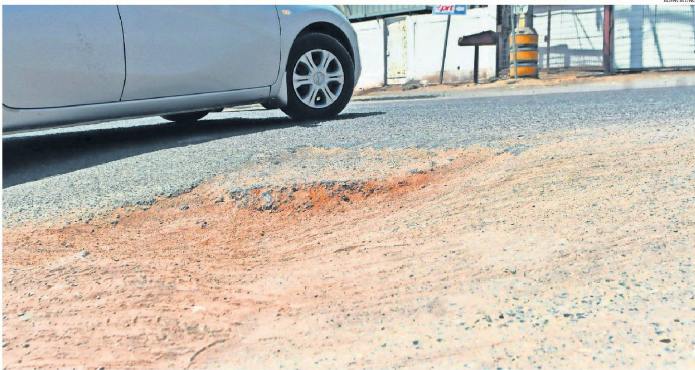
CONDUCTORES DEBEN REALIZAR MANIOBRAS EXTREMAS PARA NO DAÑAR LOS VEHÍCULOS EN LOS GIGANTESCOS HOYOS DE LAS VÍAS CERCANAS AL ACCESO SUR A ALTO HOSPICIO.
