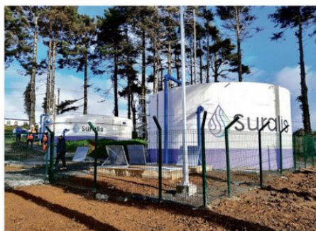
Estanques de Almacenamiento de Maullín
