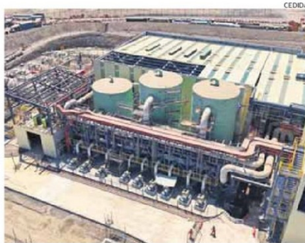
LA INFRAESTRUCTURA ABASTECERÁ A RADOMIRO TOMIC, CHUQUI Y DMH.
