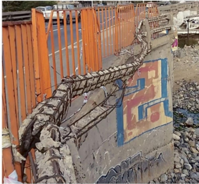
EL EVIDENTE DETERIORO EN AV. ESPAÑA.
