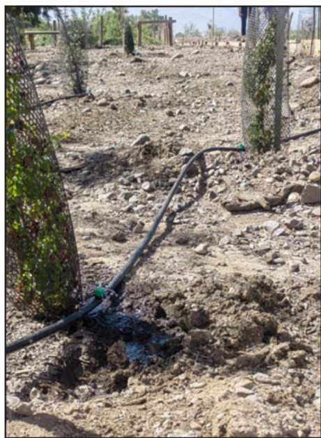
El sistema de riego tecnificado instalado en el lugar permite asegurar el crecimiento y mantenimiento de más de 400 árboles.
