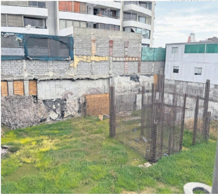
APARIENCIA INTERNA DEL SOCAVÓN, QUE SE ENCUENTRA EN PLENO SECTOR RESIDENCIAL.
