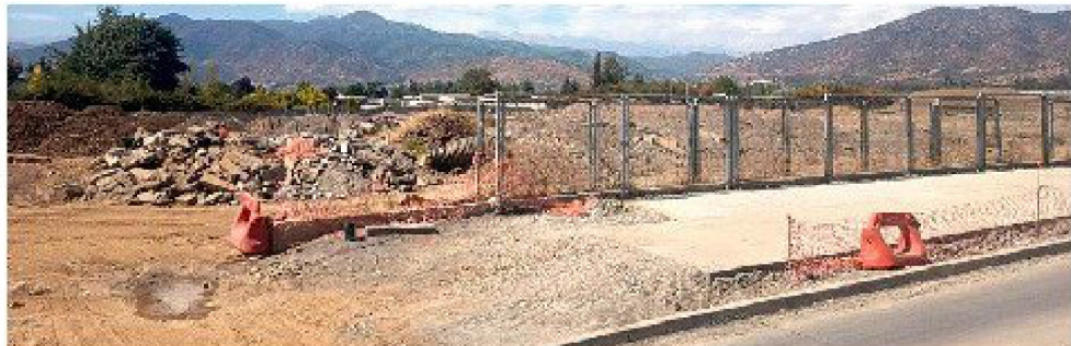
Denuncia por acopio de escombros en Machalí activa fiscalización de SERVIU.
