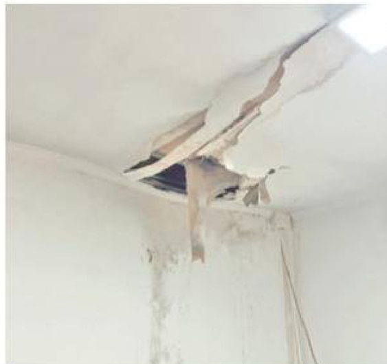
En la vivienda del docente Iván Bustos una parte del techo se desprendió por la humedad cayendo al piso del dormitorio.
