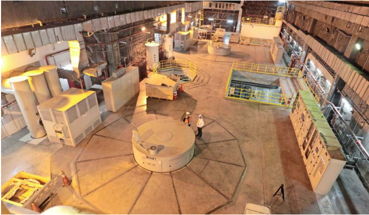
Sala de máquinas de Central Las Lajas.
