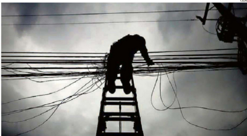
RELATAN ESFUERZOS POR MANTENER EL SUMINISTRO ELÉCTRICO A LAS FAMILIAS, PESE AL DAÑO REGISTRADO.
