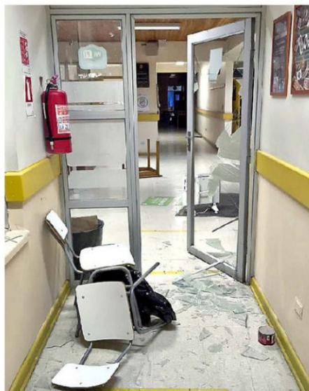
VARIAS PUERTAS FUERON TOTALMENTE DESTROZADAS.
