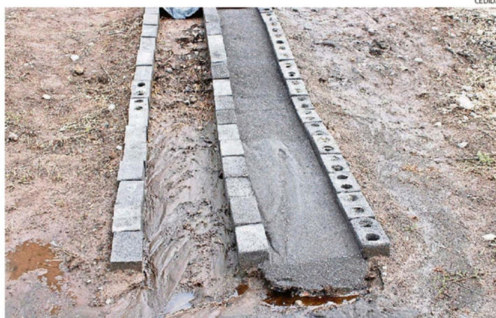
LA INICIATIVA PERMITIÓ EVALUAR EL DESEMPEÑO DEL TES FRENTE A FILTRACIONES, SOCAVACIÓN Y DESBORDOS EN INFRAESTRUCTURA DE RIEGO.
