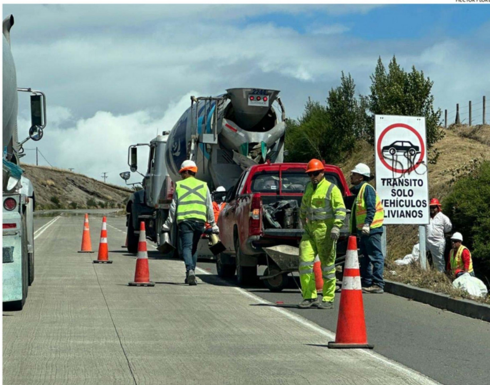
TRABAJOS DURANTE EL VERANO EN LAS CERCANÍAS DEL ACCESO NORTE DEL BYPASS DE CASTRO.
