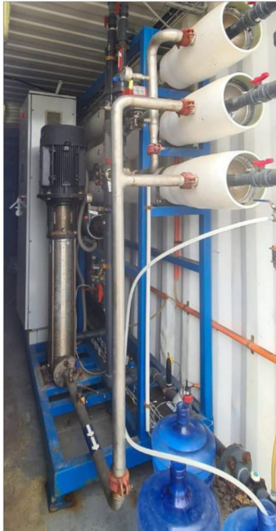
La planta que desaliniza el agua de mar para abastecer al condominio funciona por ósmosis inversa.
