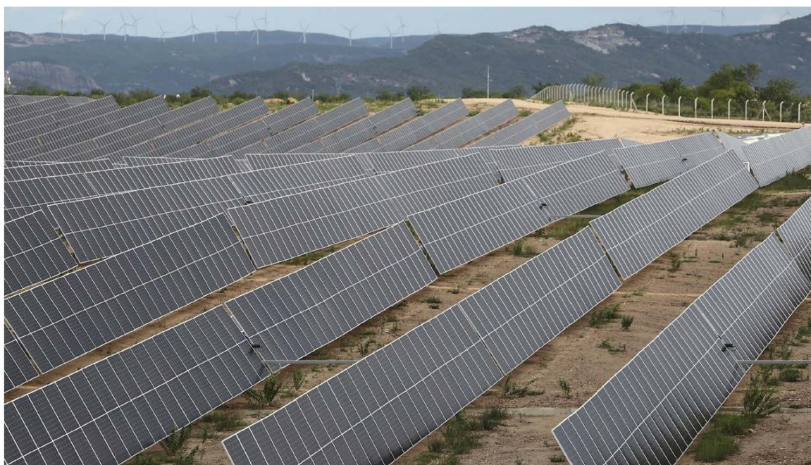
Fotografía de paneles solares en el Complejo Renovable Neoenergía, el 21 de marzo de 2023, en Santa Luzia (Brasil).
