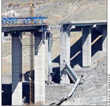
UN MISIL impactó un puente en Karaj, al suroeste de Teherán.
