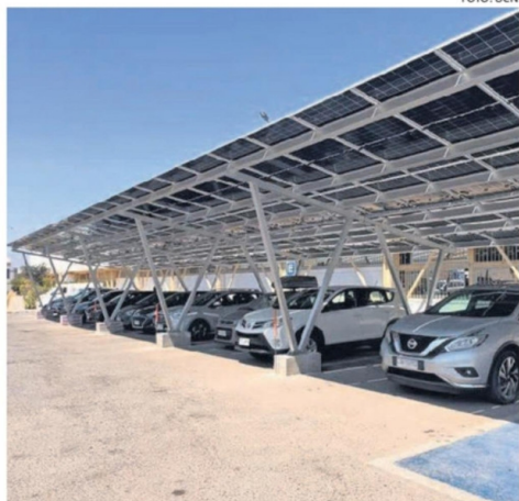
PANELES PODRÁN GENERAR HASTA 1MW DE ENERGÍA.
