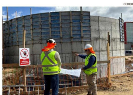
LA COMPAÑÍA CONSTRUYÓ UN ESTANQUE PARA 850 MIL LITROS EN ANCUD, EL AÑO PASADO EN CARACOLES.
