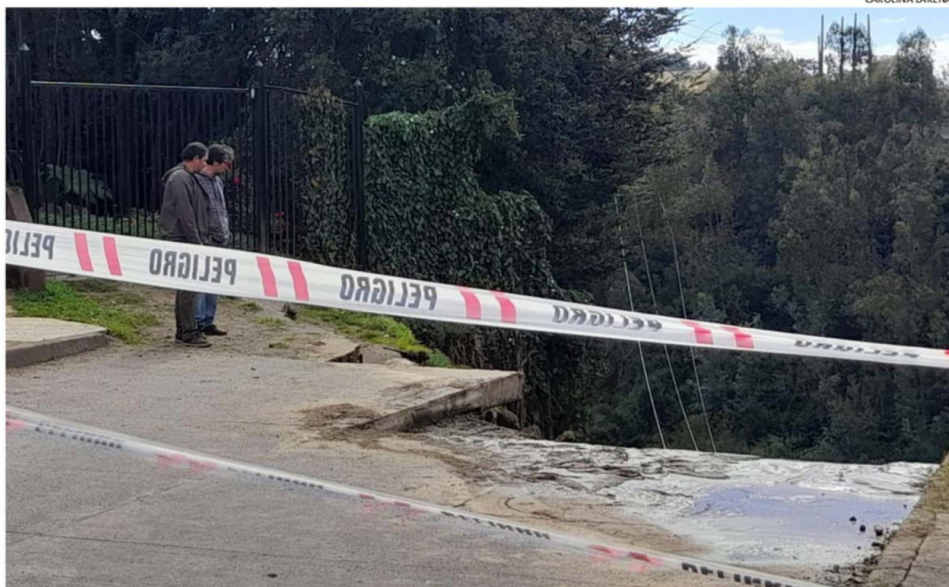
LA MAÑANA DE AYER SE PRODUJO UN NUEVO DESPRENDIMIENTO EN EL SECTOR QUINTA RAMOS.
