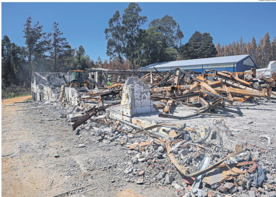
ESCUELA PUNTA DE PARRA FUE UNA DE LAS ESTRUCTURAS DESTRUIDAS POR EL INCENDIO DE ENERO.
