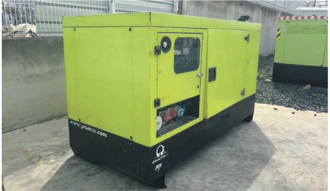
El APR La Colorada, en el sector La Isla de Combarbalá, sufrió el robo de un generador clave para el funcionamiento del sistema de agua potable rural.
