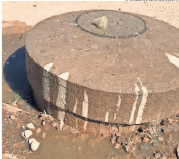
CAPTURA DE VIDEO DE UNA DE UNA DE LAS CÁMARAS SÉPTICAS FILTRANDO AGUAS SERVIDAS.
