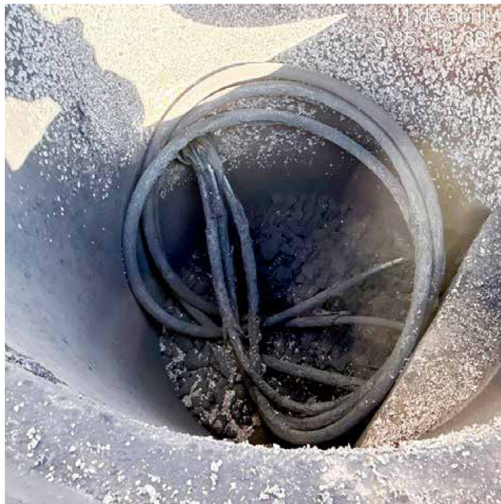
Una persona ingresó a una subestación energizada y, al intentar manipular cables eléctricos, recibió una potente descarga que le provocó quemaduras en el 90% de su cuerpo.
