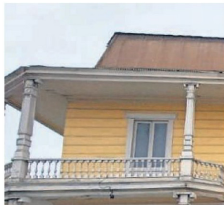
LOS BALCONES Y LA ESTRUCTURA PRESENTAN DETERIORO.
