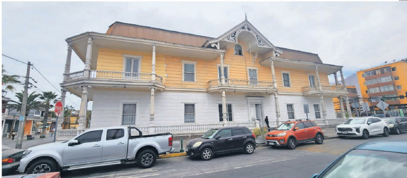
EL RECINTO ADMINISTRADO POR LA UNIVERSIDAD ARTURO PRAT SE MANTIENE FUNCIONANDO CON CIERTOS RESGUARDOS ANTE SU DETERIORO.
