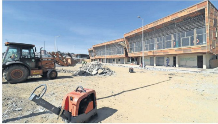
Las faenas buscan mejorar la funcionalidad de la infraestructura en el sector.
