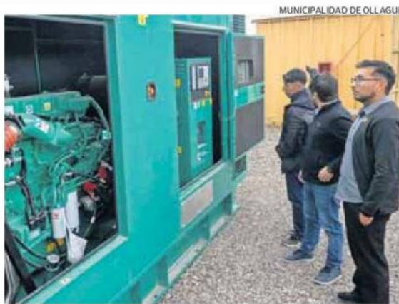
EQUIPO AUTOMÁTICO PARA CONTROLAR SISTEMA ELÉCTRICO EN OLLAGÜE.
