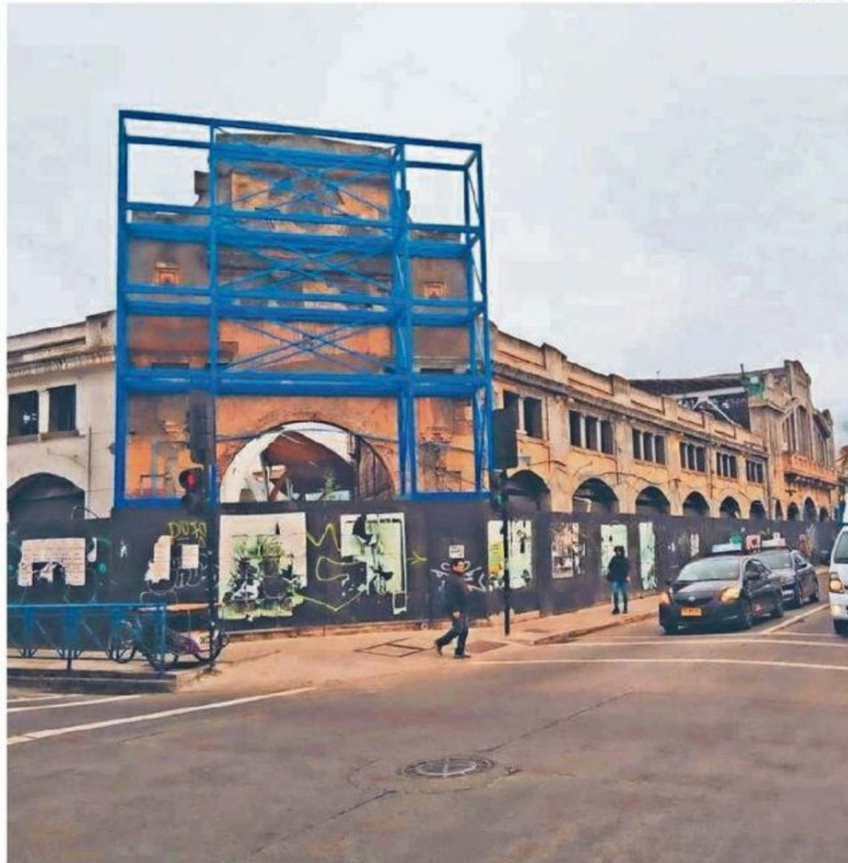
FALTAN POCOS DÍAS PARA QUE SE CUMPLAN DIEZ AÑOS DEL INCENDIO QUE DESTRUYÓ EL MERCADO.
