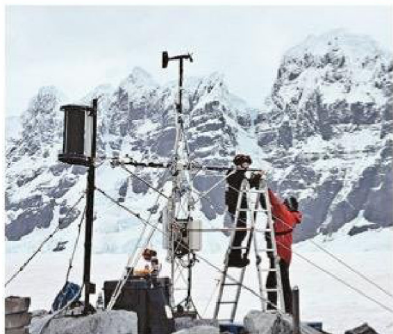
Científicos del Inach realizan mantenimiento de estaciones meteorológicas en la península Antártica durante la Eca 62.
