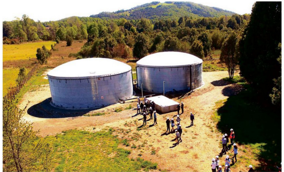
ESTANQUES DE TORMENTA DE PANGUIPULLI QUE SE UBICAN EN LA PLANTA DE TRATAMIENTO DE AGUAS SERVIDAS DE LA CIUDAD.
