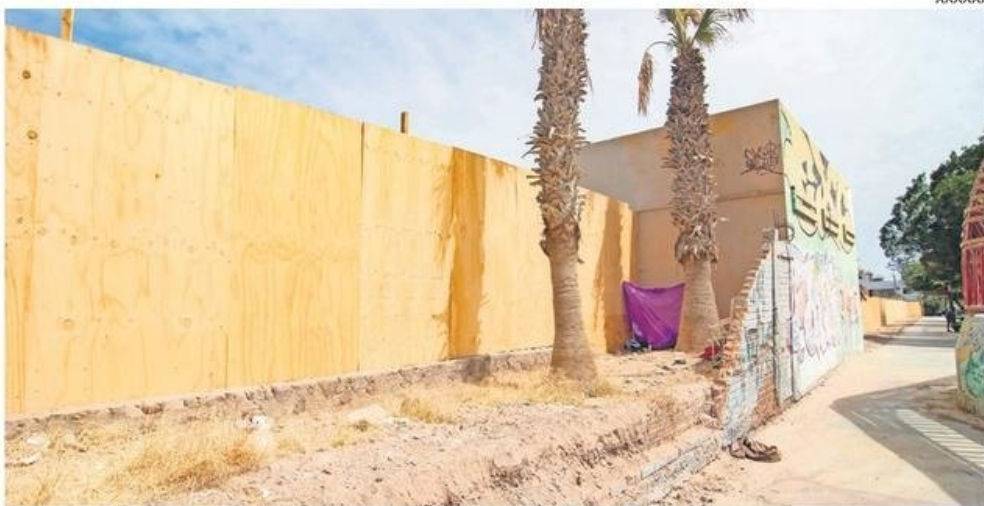
SE INSTALÓ UN CIERRE PERIMETRAL PROVISORIO MIENTRAS SE AVANZA EN EL PROYECTO.5
