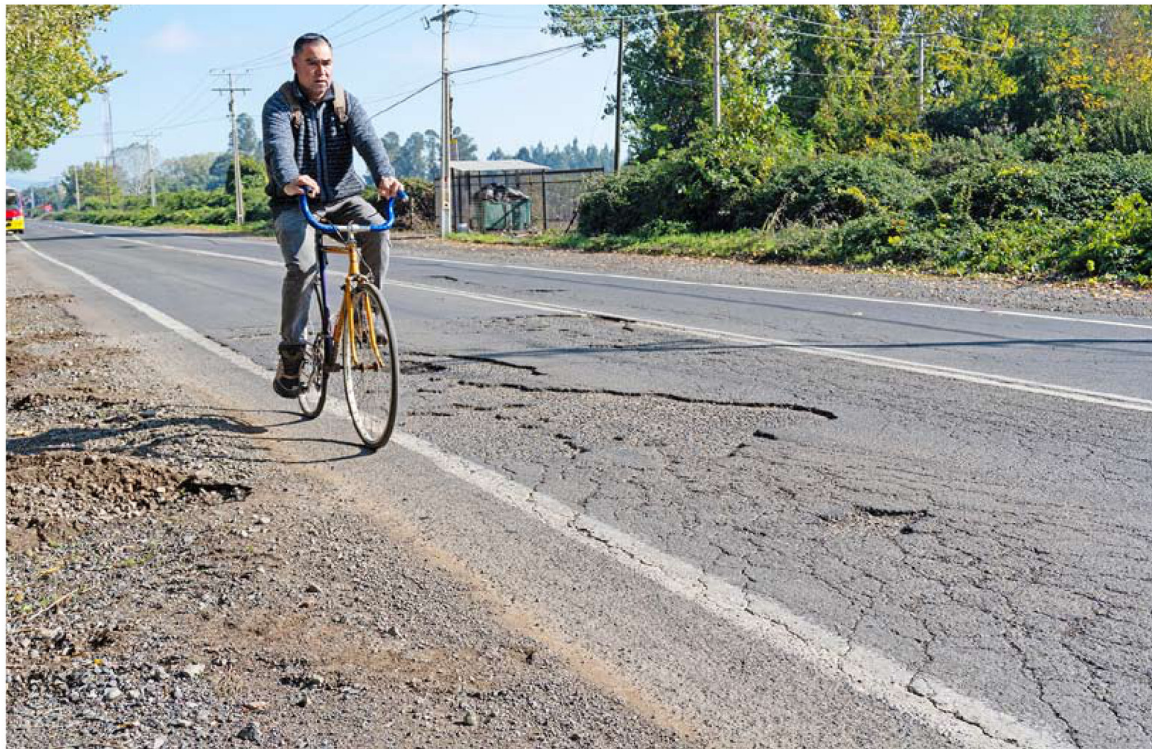
Desde el MOP señalaron que en las últimas semanas se aceleraron trabajos de bacheo en puntos específicos.
